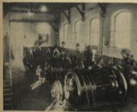
Вътрешността на електрическа централа „Панчарево“
